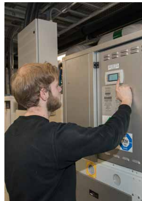
Styring av ventilasjonssystem og mekanisk vedlikehold av pumper.
